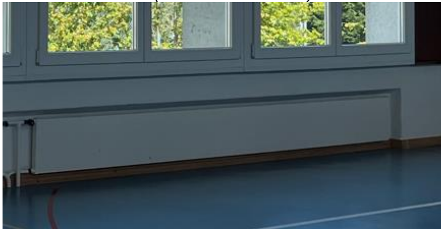
Heizwand in Turnhalle (Ventile werden ersetzt)
