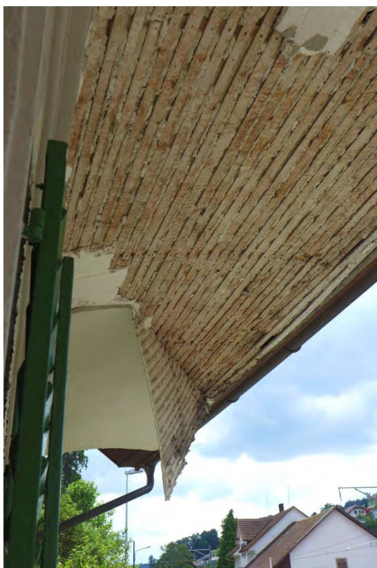
Abbröckelnder Gipsverputz an Hohlkehle (2016)
