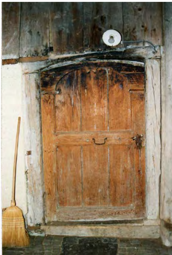
Rückwärtiger Hauseingang, Verhältnisse vor dem jüngsten Umbau (Kurzinventar 1992)
