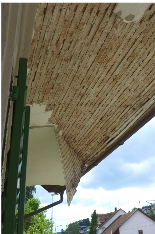
Abbröckelnder Gipsverputz an Hohlkehle (2016)
